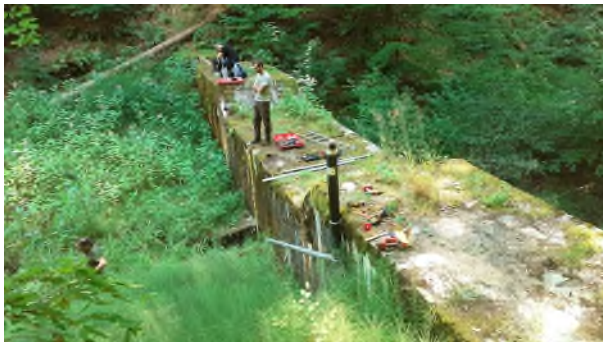
Abb. 3: Der Hochwasserwarnpegel auf der oberen Sperre im Bürgerbach angebracht. In dem Rohr steckt ein Sender, der Daten zum Pegelstand aufnimmt, verarbeitet und im Ernstfall eine Warnung per SMS versendet. Foto: Wasserwirtschaftsamt Traunstein
